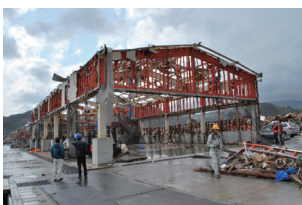
東北地方太平洋沖地震被害調査
