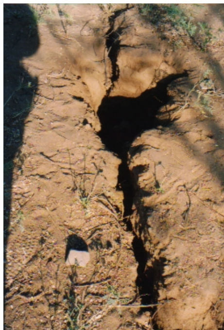
写真 32 : 左 地割れ 写真 33 : 右 詳細
