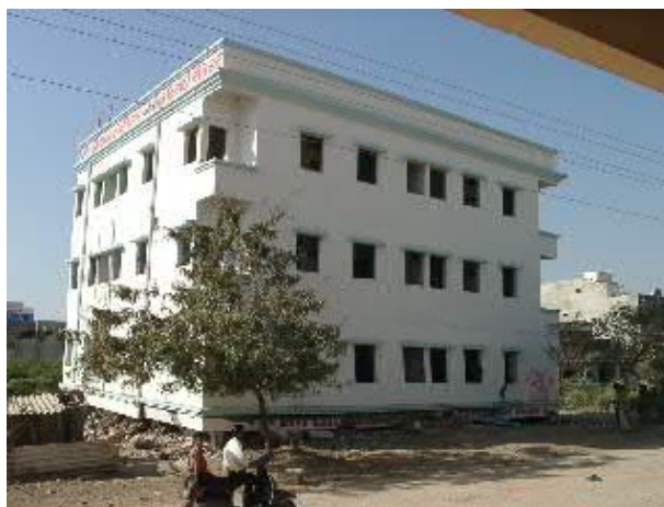
写真 25 1階部分が潰れてしまった病院
