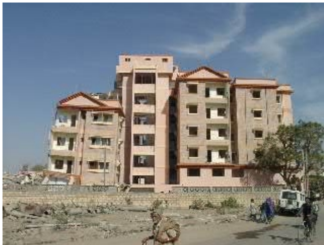
写真 20 左部分が倒壊したマンション
