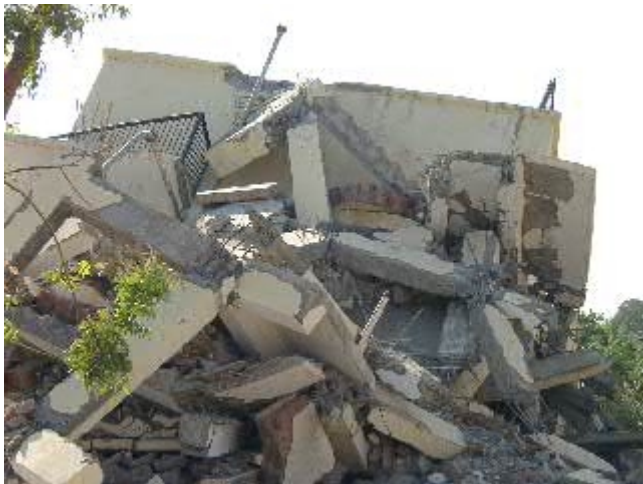
写真 31 極端な破壊をした RC の建物
