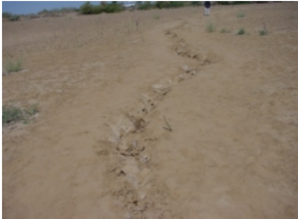
写真 28 平原に通った地割れ
